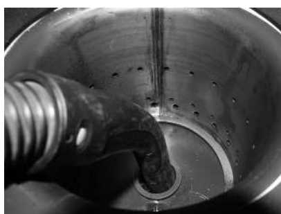
Fig. 64 Primärluftrohr in der Mitte des Brennertopfes aussaugen
