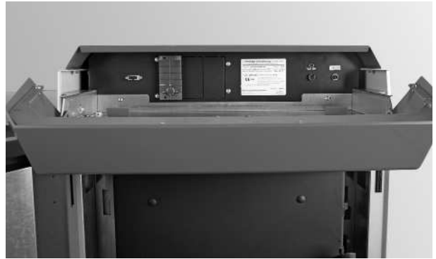
Fig. 3 Typenschild am Schaltfeld Holzvergaserkessel
